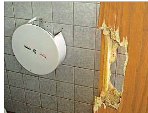
Komplett zertrümmert hat der Unbekannte auch die Innentüren der Einrichtung.
