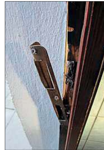
Türrahmen und -schlösser hat der Unbekannte demoliert.
