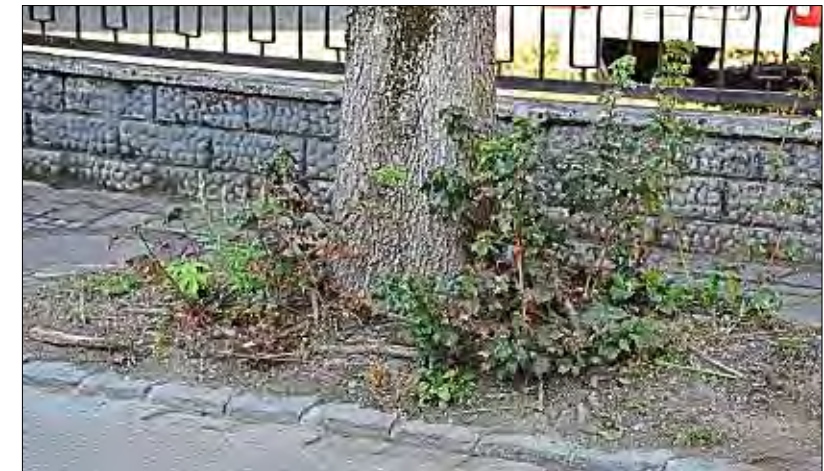
Durch das Wurzelwerk dieses Baums in der Alten Schulstraße wurde der Gehsteig zerstört – der Baum wird entfernt, ebenso wie ein zweiter dort.
