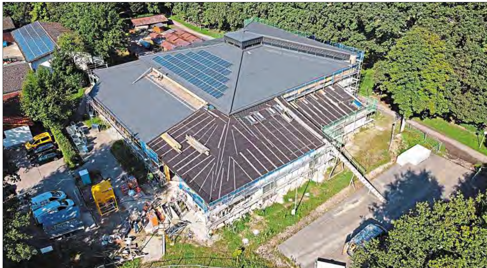
Baustelle Kurgymnastikhalle: Das Ensemble wird nun um einen kleinen Anbau für die Hackschnitzelheizung erweitert. Die Anlage soll die Halle, den benachbarten Bauhof und das Feuerwehrhaus nebenan versorgen. – Fotos: desch architekten + ingenieure
